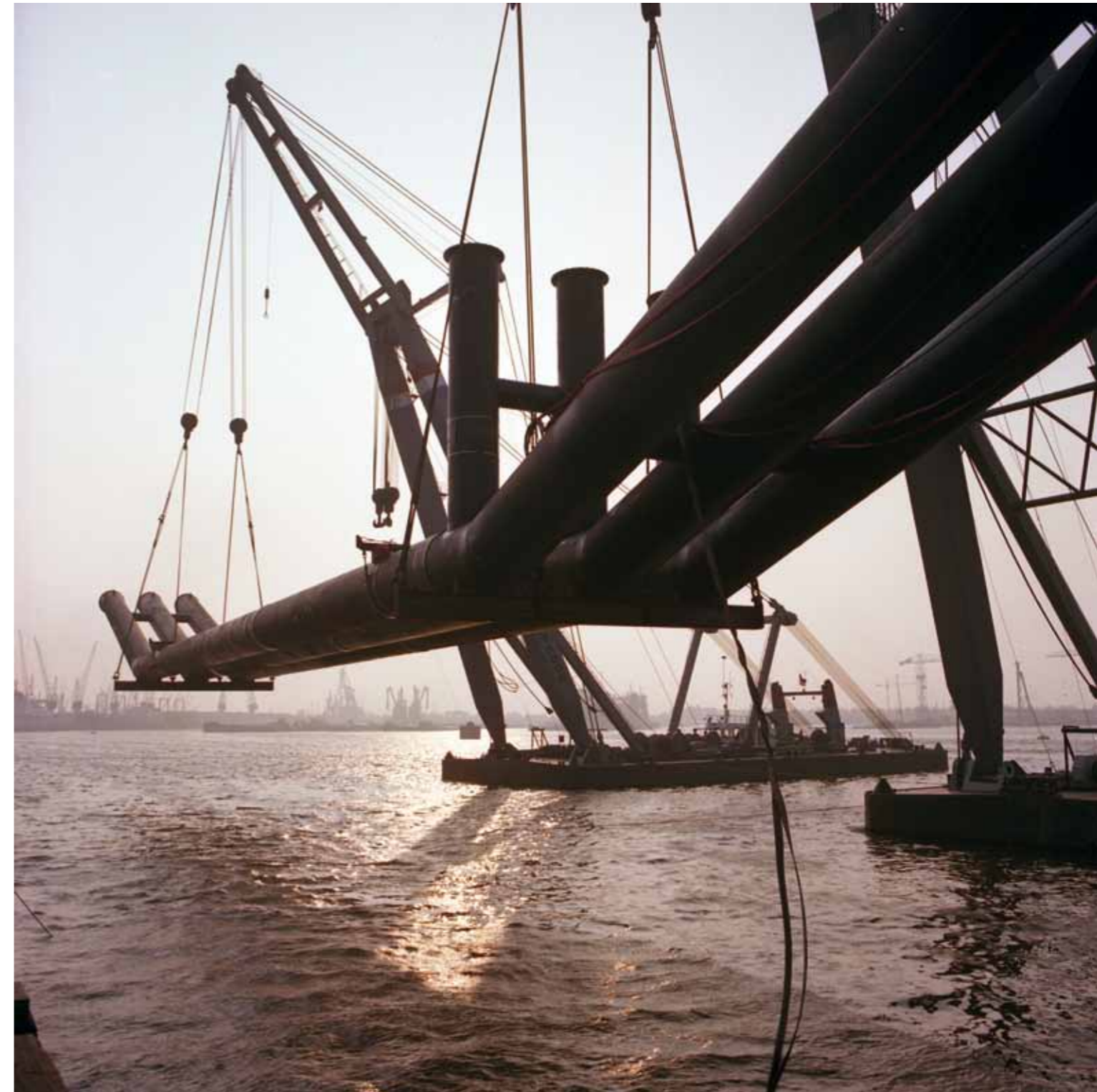
Een nieuwe duiker voor Rijkswaterstaat verlaat de Waalhaven en wordt als één geheel over water naar Limburg vervoerd.
